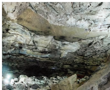
Рис. 4. Фото обрушения части кровли полости «Дружбы Народов»
