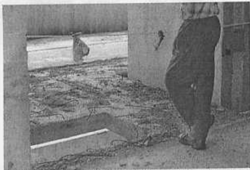
Рис.4. Проём люка. Ограждение (веревочка с тряпочками) повешено после аварии.
